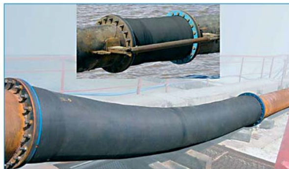
Трубопровод со сферическим фланцем в работе
